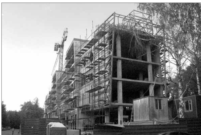
... апрель-май-июнь. Снимок апреля в предыдущей публикации об этом строительстве: руководитель проекта А. Аракелян в котловне на фоне 5-метровой опалубки.
