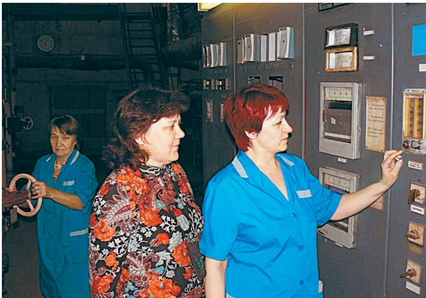
20 лет в теплоснабжении трудится мастер Дедовской котельной №8 Любовь Мануйлова (в центре)
