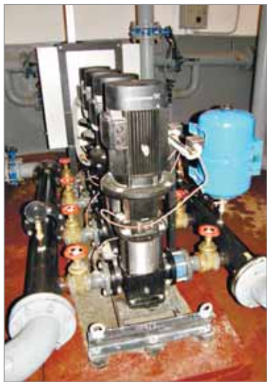
На водозаборном узле установлено самое современное оборудование
